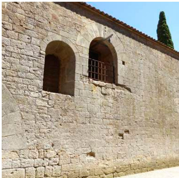
Fig. 25 : Vue de la baie du cellier, piégée dans la voûte basse, et de la porte du grenier. À noter la différence de parement entre les piédroits gauche et droit de la baie, la rupture d'assise et le changement de parement entre les parties nord et sud du cellier.
