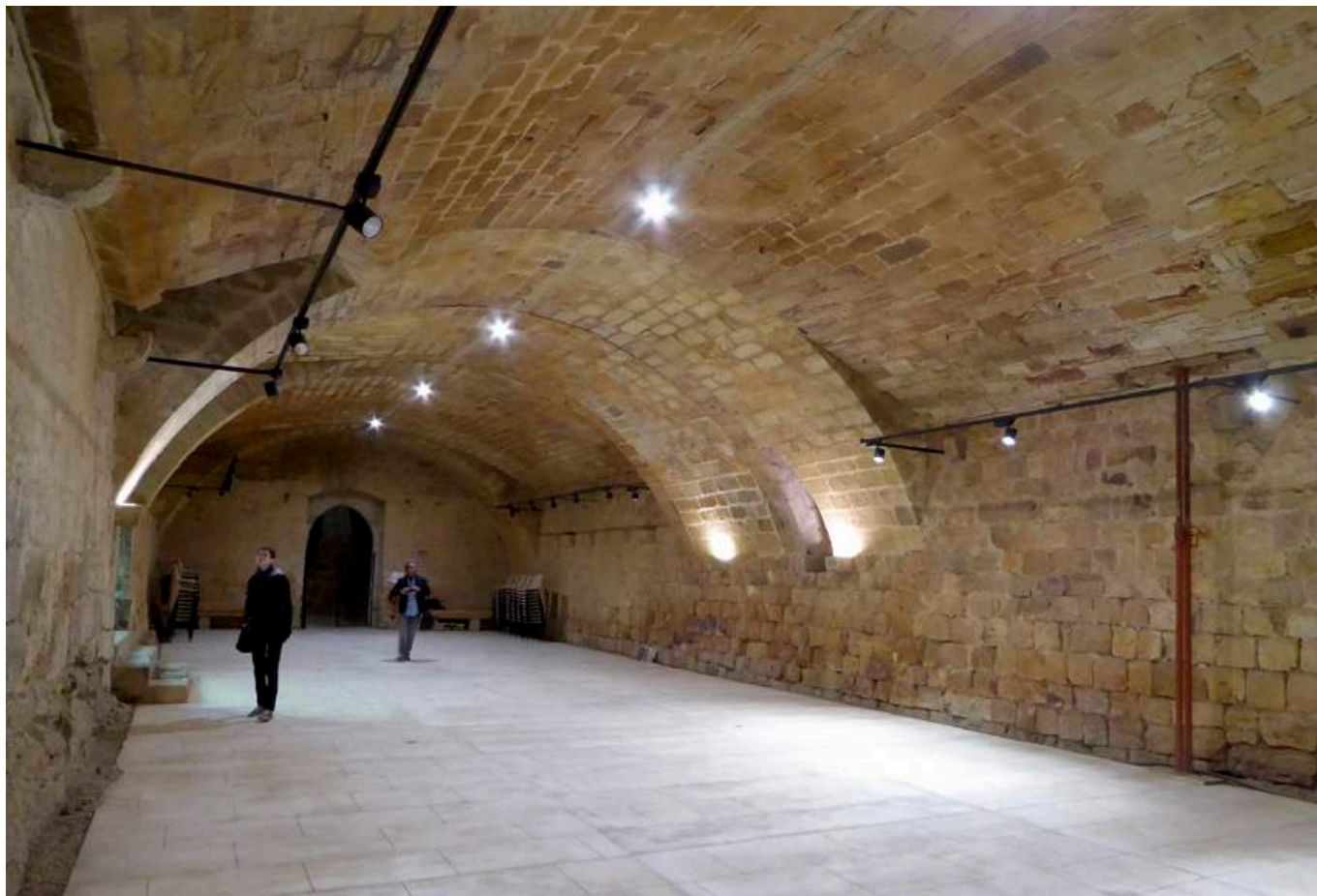
Fig. 12 : Détail, au droit de la baie occultée de la salle basse, du désordre affectant la partie sud du voûtement du cellier.
