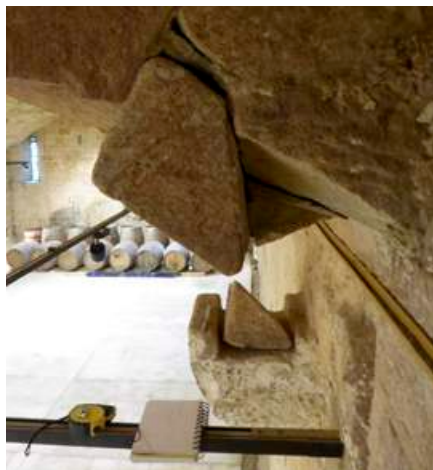
Fig. 29 : Détail du défaut de conception de la voûte sud au rez-de-chaussée du cellier, ayant provoqué la rupture localisée d'un claveau de sommier mal profilé.
